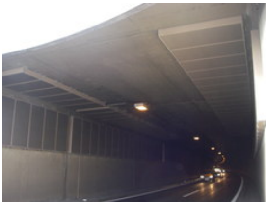
Abb. 1: Unterflurtrasse Lendorf im Bundesland Kärnten. Die Filter sind an Decken und Wand des Tunnelportals angebracht
