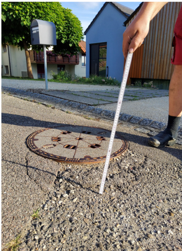
Hervorstehende Schächte wie hier am Pfeffingerweg verlangen nach Sofortmassnahmen.
