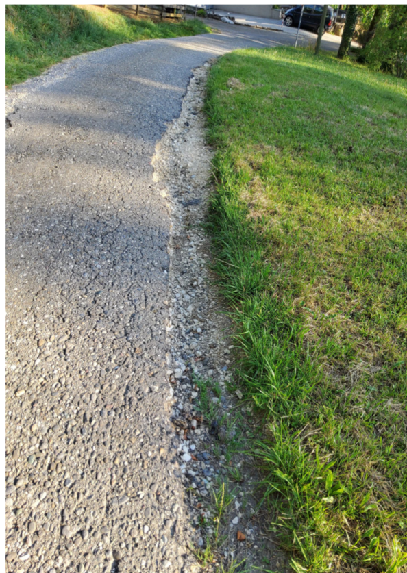
Der Weidweg ist in einem schlechten Zustand und soll im nächsten Jahr erneuert werden.
