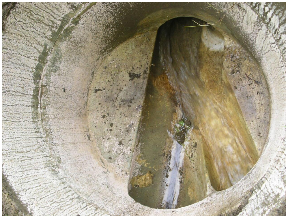
Abbildung 16: Kontrollschacht beim Zusammenschluss zweier Sammelleitungen
