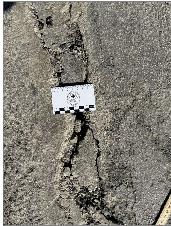
Abbildung 3: Klaffende Risse in der Berstelstrasse
