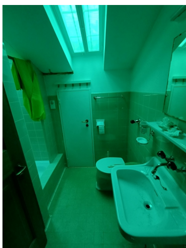
Dusche/WC DG mit Leck Dachfenster
