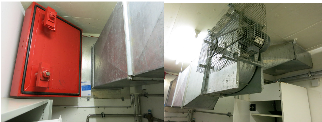
Ortsfester Abluftventilator separat geführt, Austritt aus der Schutzanlage mittels Panzerdeckel (beim Bezug der Schutzbaute: Kanalstück demontieren, Panzerdeckel schliessen).
