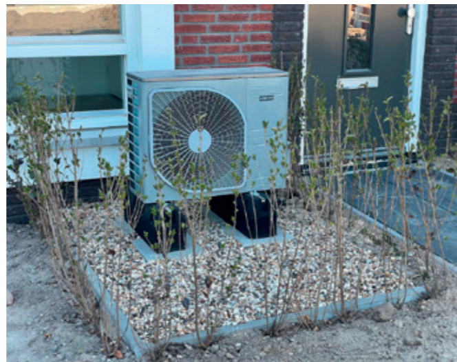
Wärmepumpe bei einem Mehrfamilienhaus (Quelle: Pixabay)
