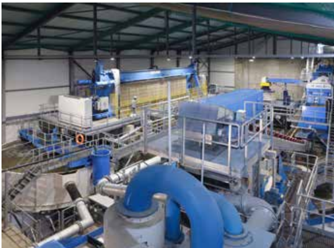
Aushubwaschanlage (Halle) für verschmutztes und unverschmutztes Aushubmaterial in Allschwil (Quelle: habö AG, Allschwil – Ein Unternehmen der Tozzo-Gruppe).
