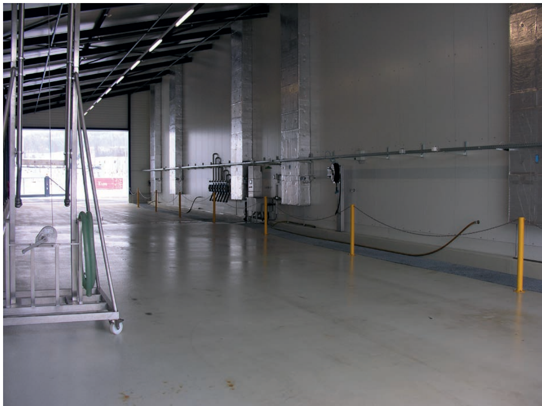
Umschlagplatz für Tankfahrzeuge mit mediumbeständigem Boden und Auffangwanne, Halag Chemie AG, Aadorf
