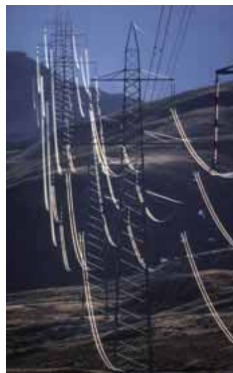
220-kV-Freileitung bei Laax GR.
