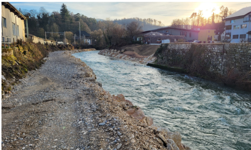
Die Baupiste liegt bereit. Im oberen Teil des Abschnitts Delsbergerstrasse beginnen im Februar 2026 die Arbeiten an der Uferverbauung der rechten Birsseite (im Bild links zu sehen). (Bild: Holinger AG)
