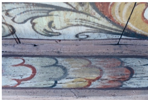
8.9 Detail Verschmutzung Balkenwange
