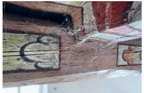
8.5 Verschmutzungen sind teilweise umfangreich, jedoch gering mit dem Untergrund verbunden.
