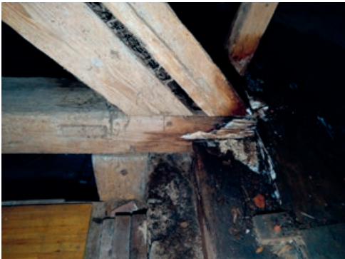
7.8 Durchnässung einer neuralgischen Stelle des Dachstuhls infolge mangelnden Unterhalts. Anschluss Stuhlstreben- und Sparrenfuss des Querbundes zum Bunddachbalken.
