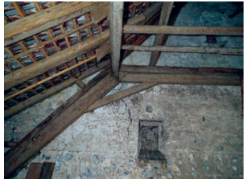
7.9 Der fatale Eingriff auf der einsturzgefährdeten Südseite: Die ursprüngliche Symmetrie des Dachstuhls wurde verändert, die Sparren wurden auf der Höhe des Stuhlrähms gekappt, stabilisierende Teile des Längsbundes entfernt und das Vordach mit aufgelegten Sparren verlängert.
