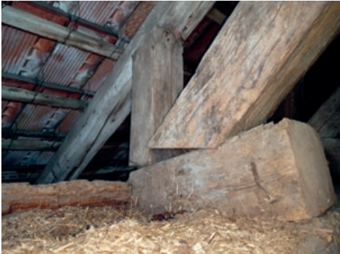
7.6 Fehlender Formschluss Detail Auflager Sparrenfuss: Die Auskragung des Vordachs neigt das Sattelholz gegen aussen, der Sparren wird aus seiner Verankerung gehoben.
