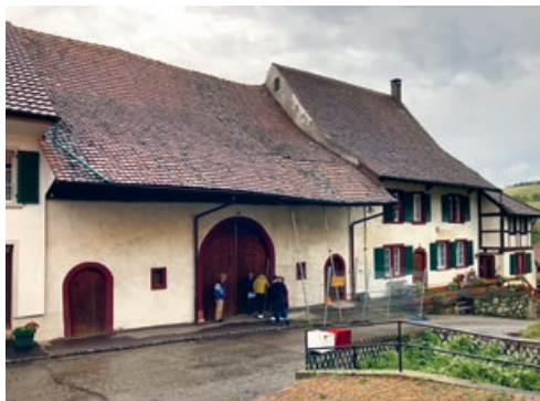
7.2 Ehemaliger Gasthof Hirschen mit Anbau (ganz rechts) und mit der zugehörigen Ökonomie, Bauerngasse 60 a, links vom Wohnhaus von der Bauerngasse betrachtet. Im Bild sind die stark deformierten Dachflächen und die Notspriessung des Traufschärmens erkennbar. Das Vordach ist einsturzgefährdet.
