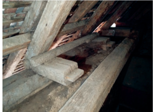
7.7 Fehlender Kraftschluss in der Zapfenverbindung des Sparrensattels. Der Zapfen hat sich komplett aus der Verbindung gelöst.
