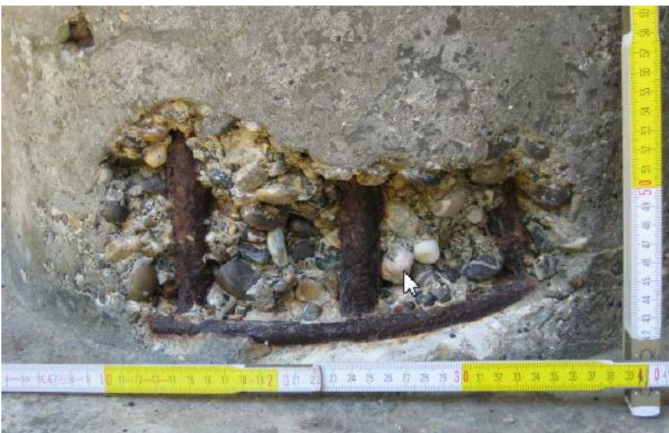
Abb. 09: Freiliegende und rostige Armierung an einem Stützenfuss
