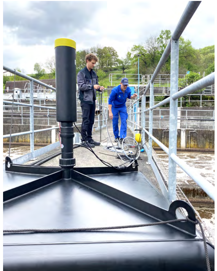
Installation der Abluft- hauben zur Lachgas- messung.
