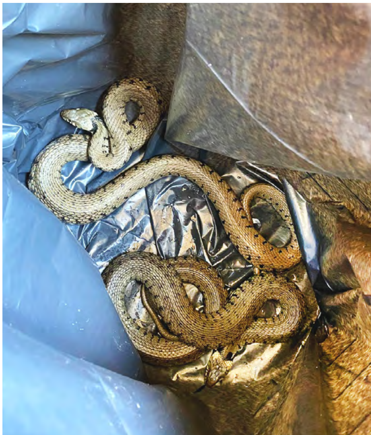
Fundstücke: angeschwemmte Ringelnattern im Abwasserpumpwerk Fischzucht in Augst.
