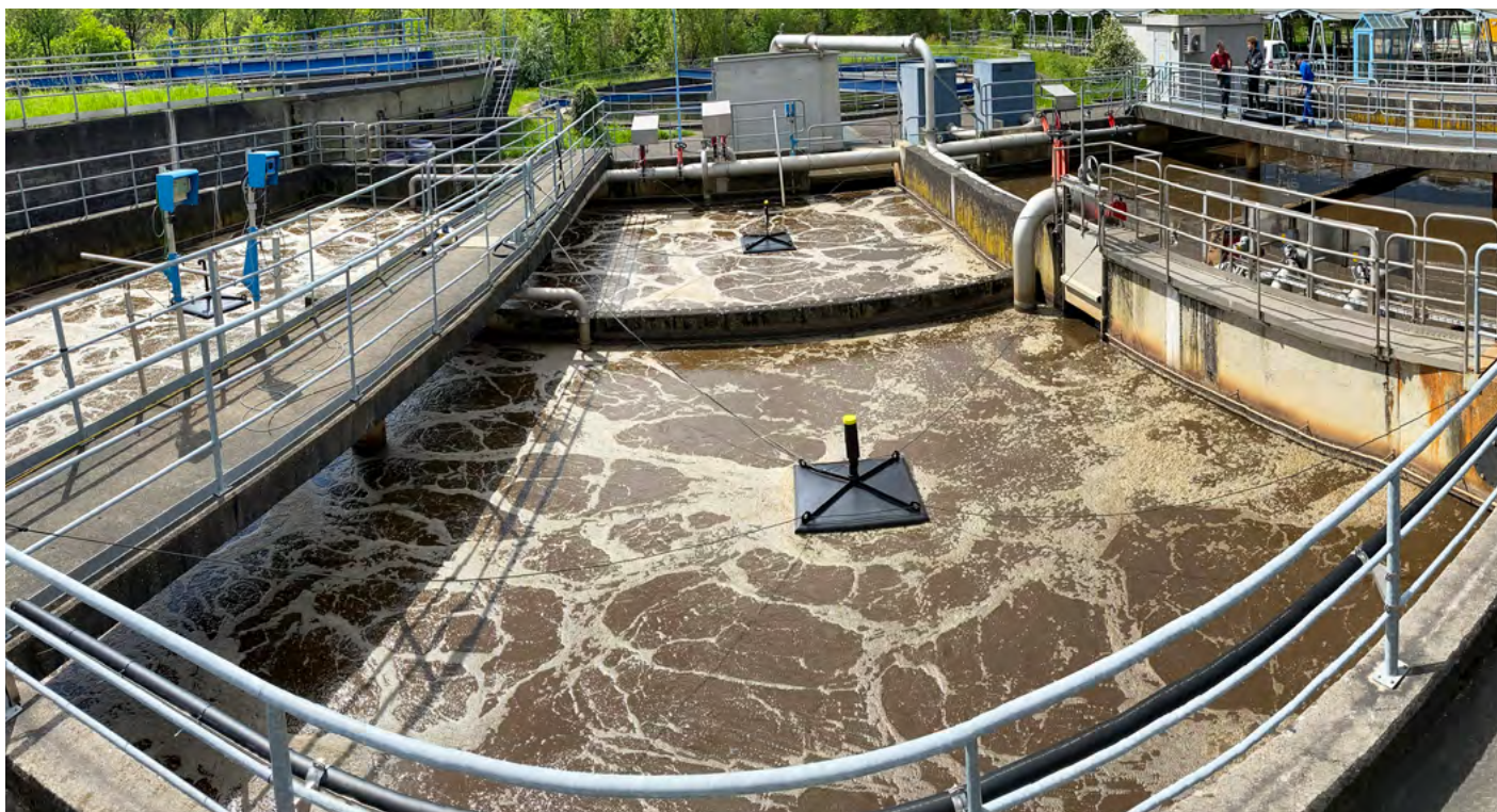
Die Ablufthauben zur Lachgasmessung auf der Anlage ARA Ergolz 2 in Füllinsdorf.
