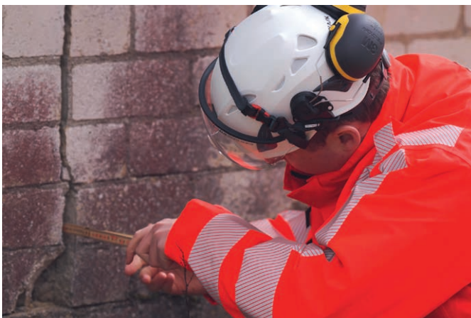
Mitglied Ingenieur-Team bei der Messung von Rissen
