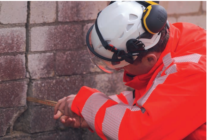
Mitglied Ingenieur-Team bei der Messung von Rissen
