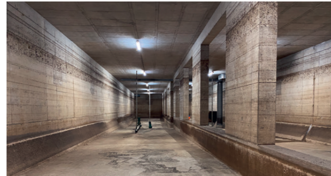
Das Mischwasserbecken Weiermatt in Liestal wurde 2020 in Betrieb genommen (Quelle: AIB)
