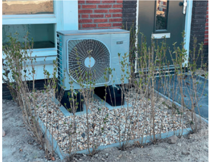
Wärmepumpe bei einem Mehrfamilienhaus (Quelle: Pixabay)
